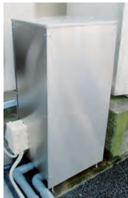
活性炭ろ過槽外観
