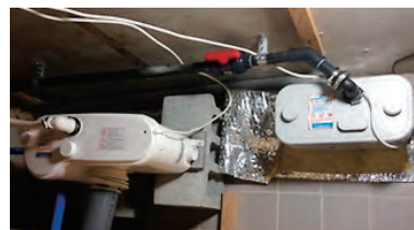
トイレ用圧送ポンプ(左)と雑排水用圧送ポンプ(右)
