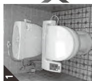
止水栓を止めてください。
