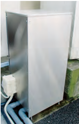
活性炭ろ過槽外観
