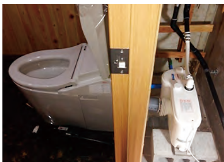
便器の後ろに圧送ポンプを設置し、 メンテナンススペースを設けました。
